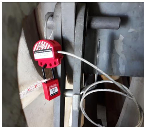
Bloqueo del tren de potencia consignado en una de sus pletinas. Locked and tagged out drive train plate unit.
