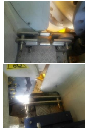
Pletinas de bloqueo del eje lento en posición normal. El sistema está compuesto de 2 pletinas, situadas cada una en cada lado del eje lento. Slow shaft blocking plates in normal position. The system consists of two plates located one on each side of the slow shaft.
